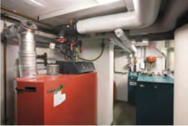
Heizkessel und Blockheizkraftwerk
