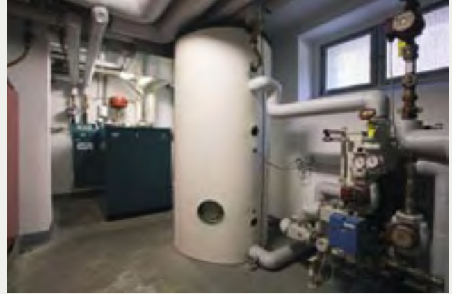
Heizungstechnik nach neuestem Standard
