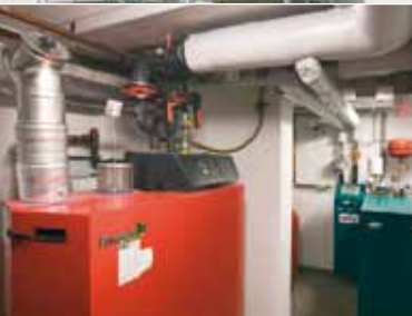
Heizkessel und Blockheizkraftwerk
