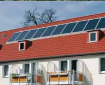
Dach mit Solar- kollektoren zur Warmwasser- aufbereitung
